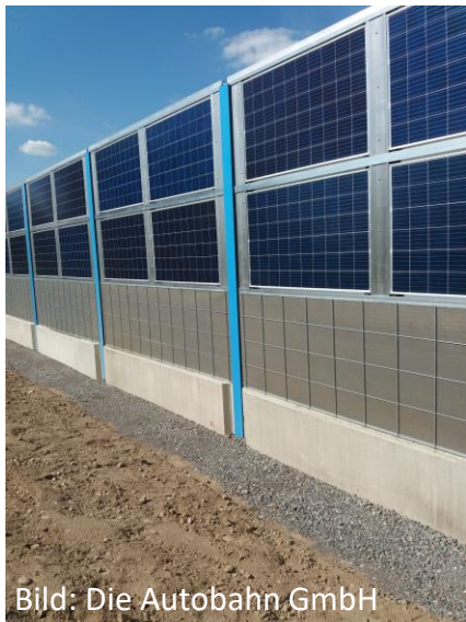
PV-Anlage an Lärmschutzwand
