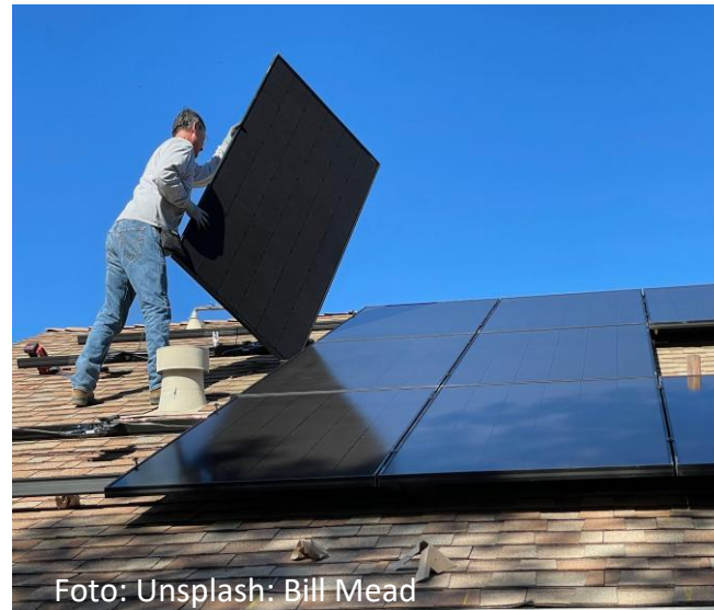
PV-Anlage auf Wohnhaus
