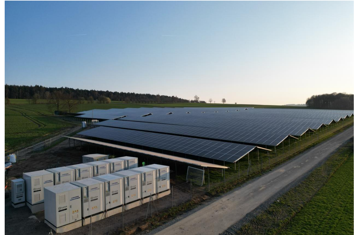
5,2 MWp PV-Anlage in Ost-West Ausrichtung
